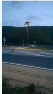
LED Beleuchtung, PV & Speicher Radweg Kinding
